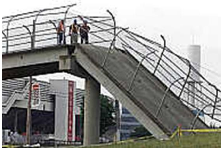
Рисунок 5 - Обрушение пешеходного моста в городе Конкорд, штат Северная Каролина, США [3]
