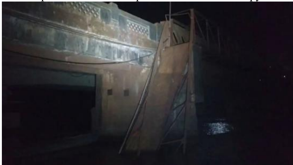
Рисунок 9 – Последствия разрушения пешеходного моста на Гоа [8]
