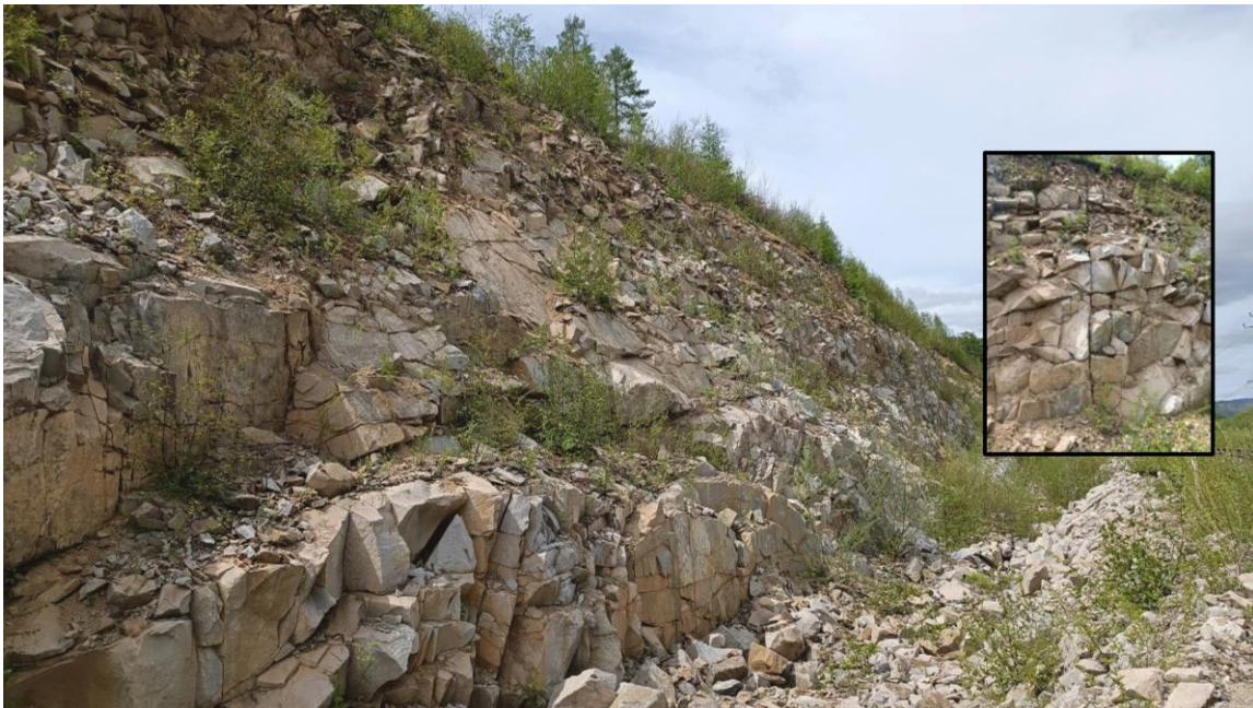
Рисунок 2. Повышенная трещиноватость и блочность скальных горных в зонах тектонических нарушений выявленная в откосах выемок и полувыемок.
