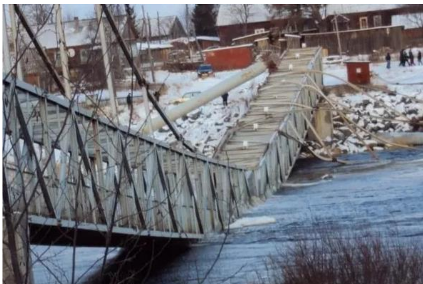
Рисунок 2 - Обрушение пешеходного моста в Карелии [3]
