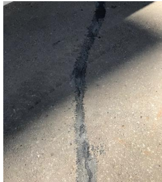
Рисунок 7. Результат ремонта трещины. Разная скорость высыхания суспензии на солнечном и теневом участках (составлено авторами)
