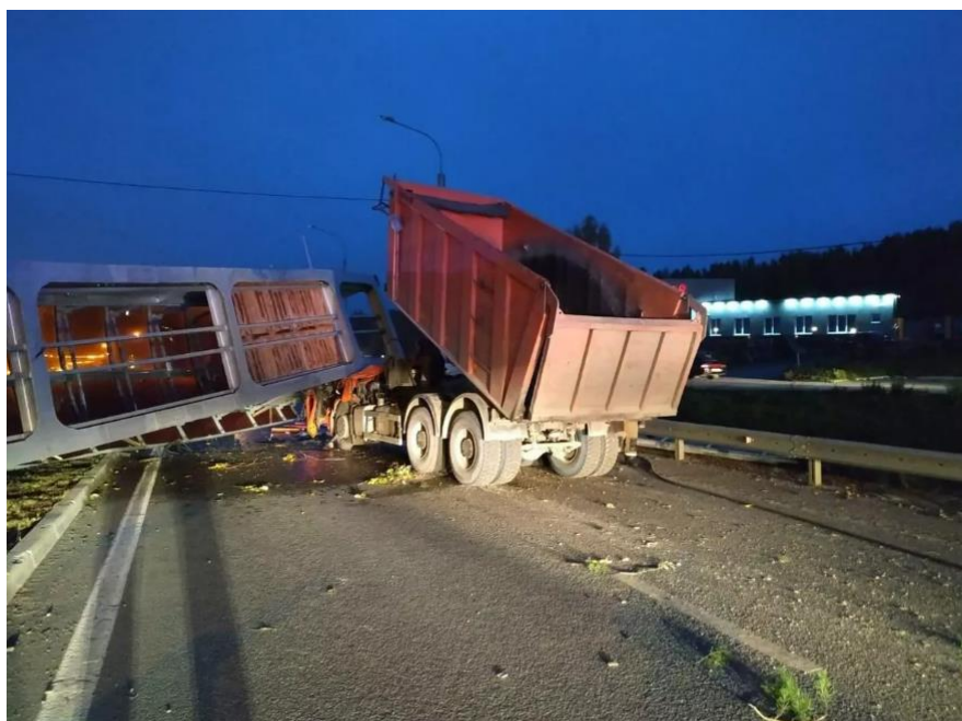
Рисунок 10 – На месте обрушения надземного перехода на трассе "Урал" [5]
