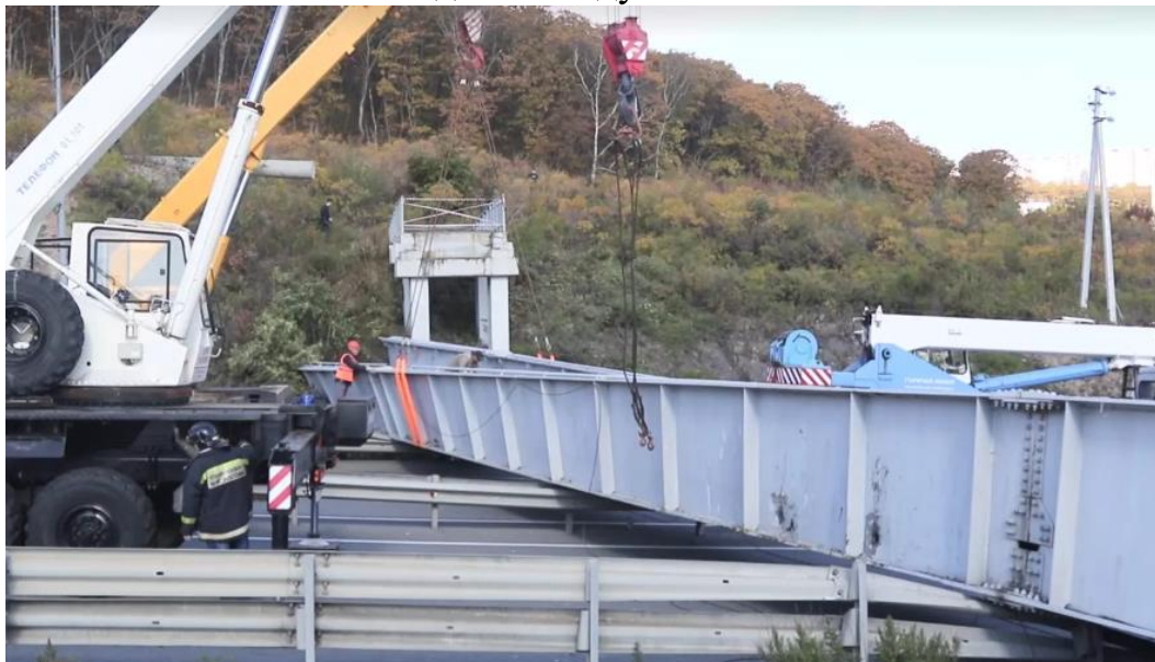
Рисунок 12 – Обрушение пешеходного виадука во Владивостоке [5]
