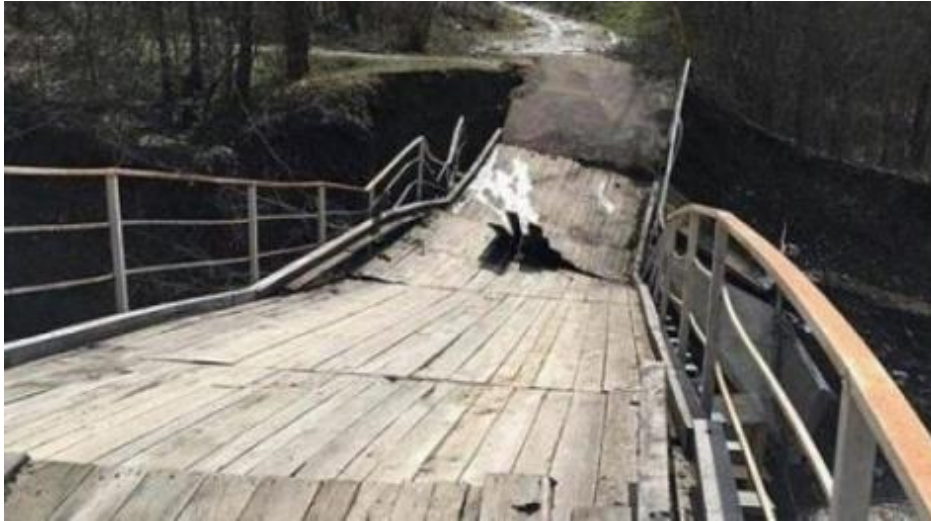
Рисунок 7 - Обрушение пешеходного моста через реку Хадажка [6]
