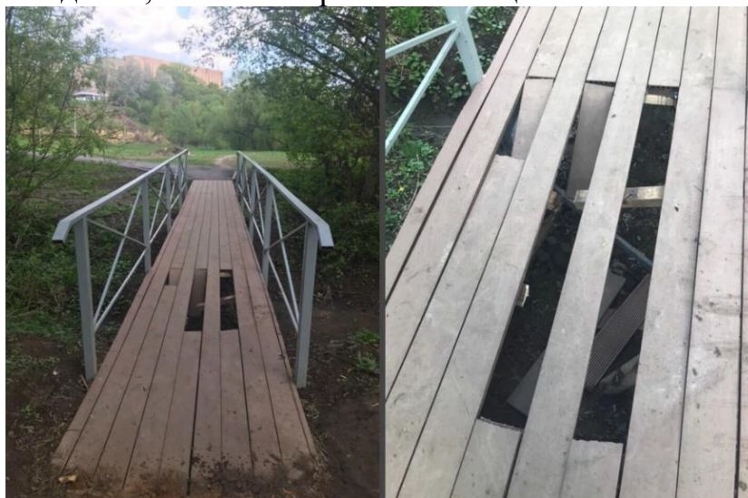
Рисунок 4 - Обрушение пешеходного моста в Орловском парке [4]
