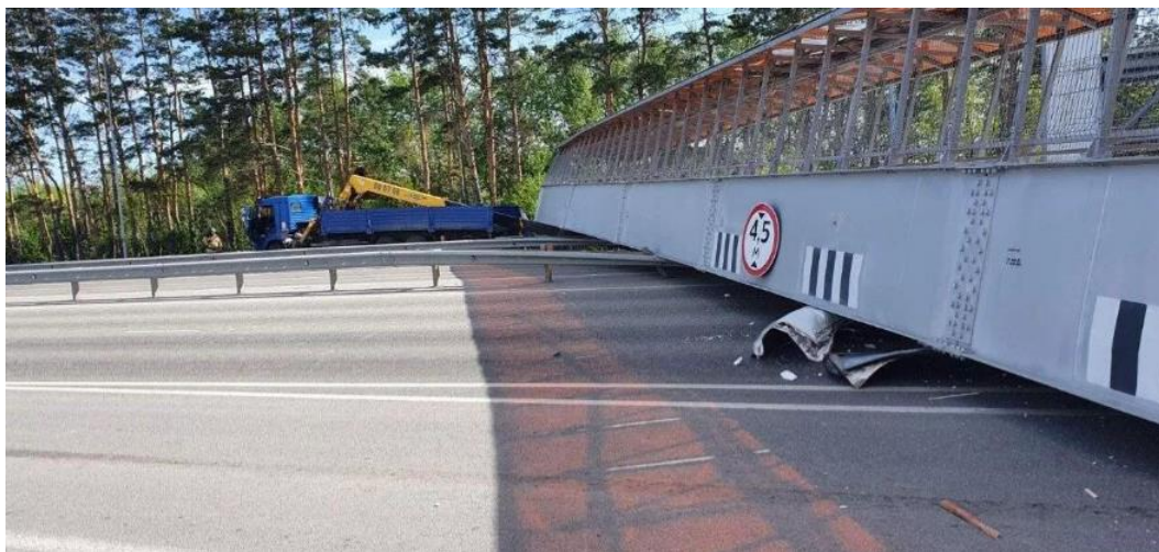
Рисунок 11 – На месте обрушения надземного перехода в Тюменской области [5]
