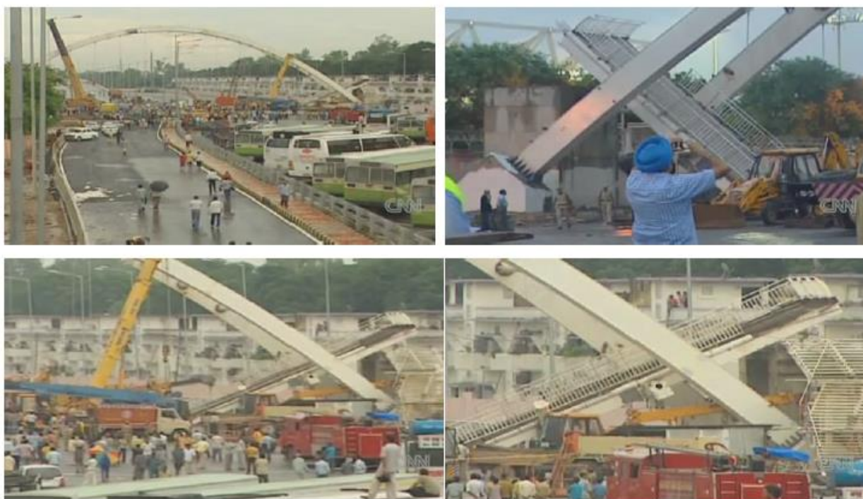
Рисунок 3 - Обрушение пешеходного моста в Нью-Дели [3]
