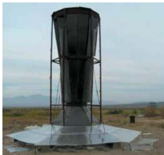
Рис. 2. Экспериментальная электростанция «Торнадо - 2С» в Шелекском ветровом коридоре (Казахстан)
