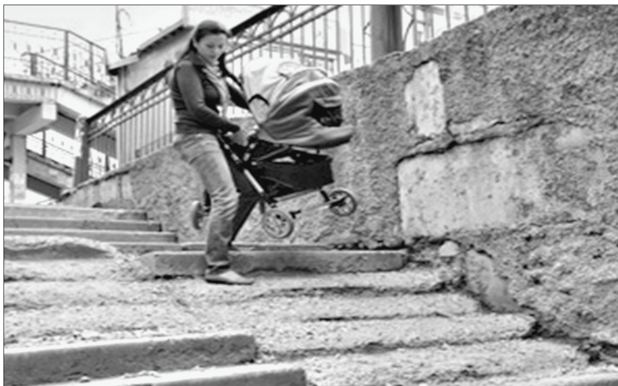
Разрушенная лестница, район Второй Речки, г. Владивосток
